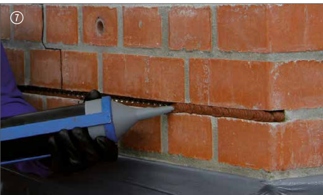
Zweite Lage DESOI Spiralankermörtel einbringen Insert second layer of DESOI Spiral Anchor Mortar
